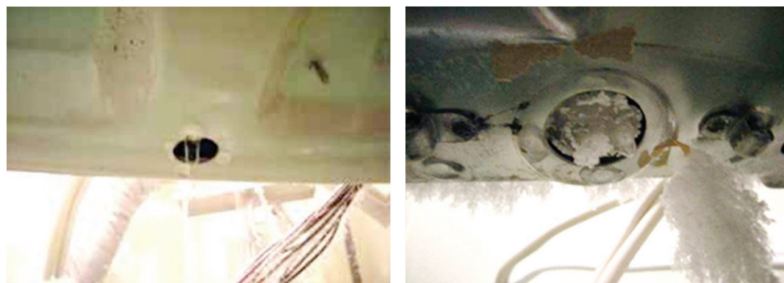
Rys. 4. Zabezpieczona i niezabezpieczona grzałką taca skroplin jednostki zewnętrznej
