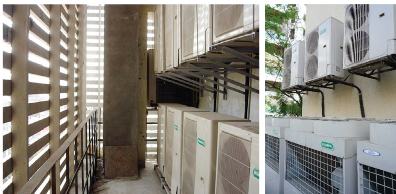
Rys. 2. Przykład nieprawidłowego montażu jednostek wewnętrznych
