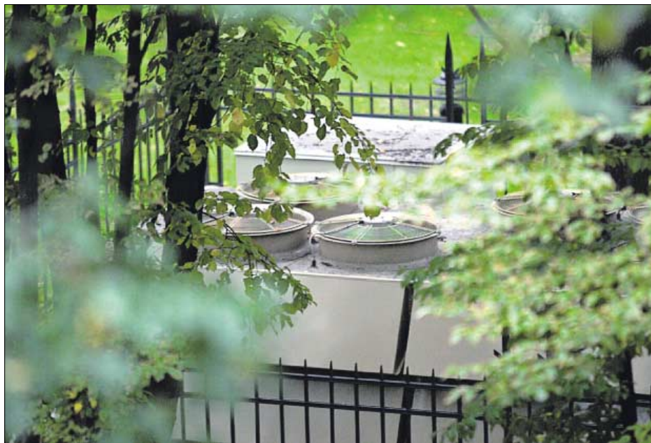
W klimatyzacji stosowane są środki, które mogą być niebezpieczne dla środowiska naturalnego
