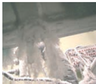
Oblodzony wypływ skroplin – narastanie lodu może uszkodzić wentylator jednostki zewnętrznej
