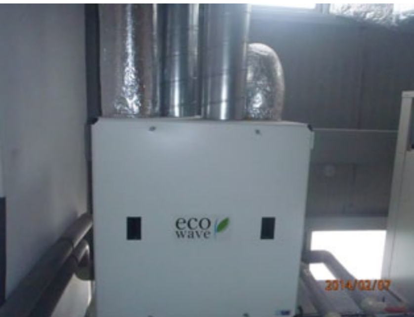
Rekuperator z podłączonymi kanałami, każdy o średnicy 160-200 mm
